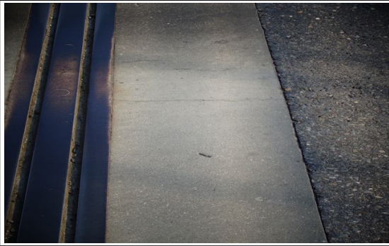
A1 후타재 균열 (원주방향)
