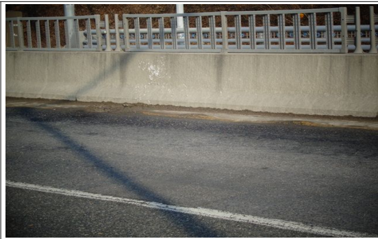
S32 망상균열 및 소성변형 (원주방향)
